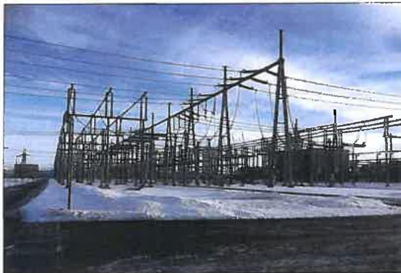
HAGAFJELLET : Sogndal stasjon er den største av dei seks transformatorstasjonane som er bygd inn i den nye 420 kV-lina mellom Sogn og Sunnmøre, no blir krafta handtert oppe i på fjellet mot tidlegare inne i busebnaden i Fardal. Foto: Statnett.
